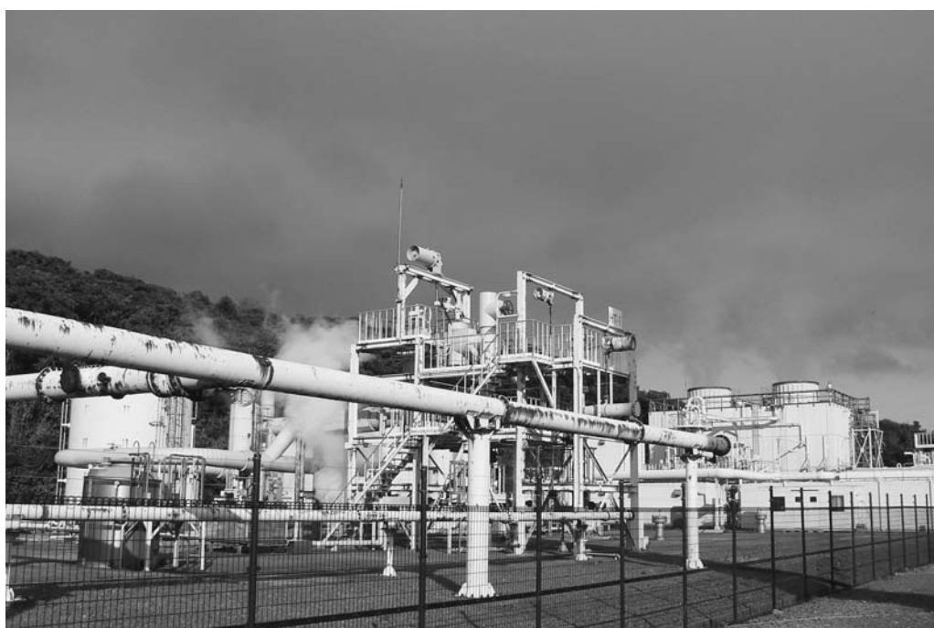
東京電力地熱発電所
