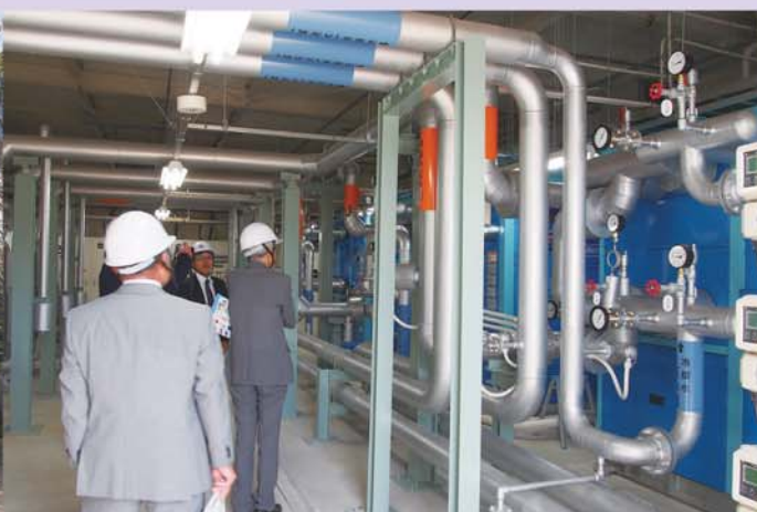
バイナリー発電所
